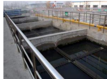
(f) 污水处理池
